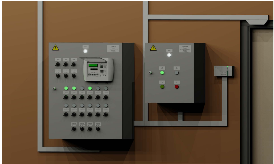
•• Рис. 3. Щит автоматизации внутреннего газоснабжения (АГСВ)
